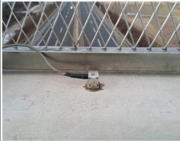
가속도계 설치 현황
