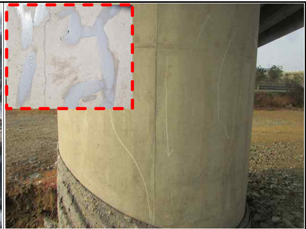
교각 균열(폭 0.2mm)(보수완료)
