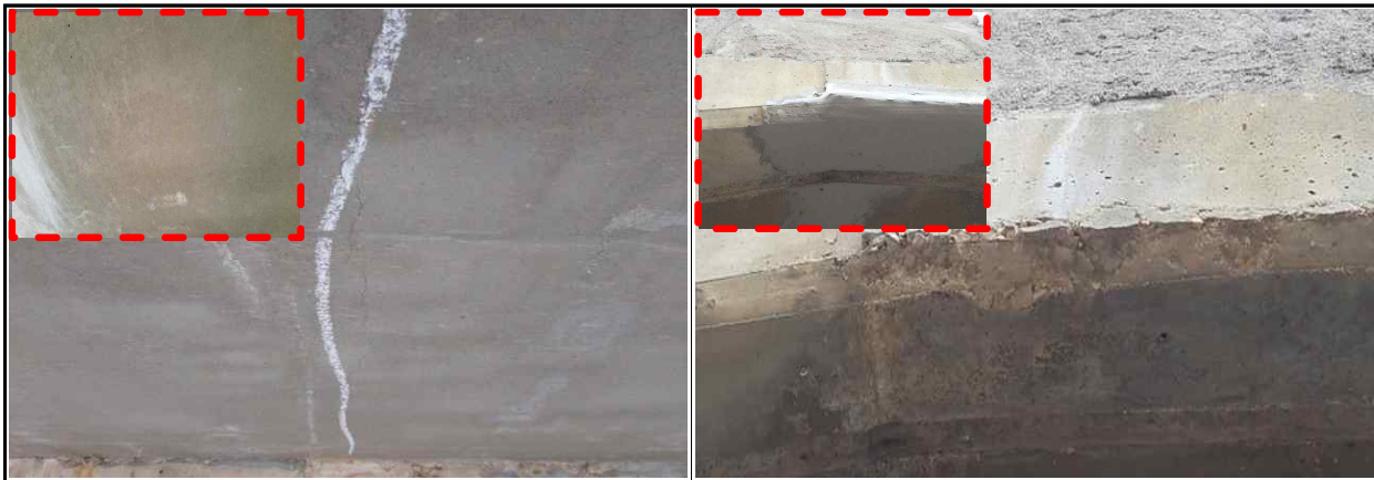
바닥판 하면 균열(폭 0.1mm)(보수완료)
